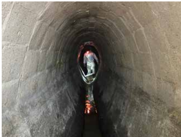
Obr. 1 Původní vejčitý profil DN 1100/1850 před sanací; patrná je nepravidelná geometrie a poškození dnové části. Foto: archiv TRASKO BVT.
