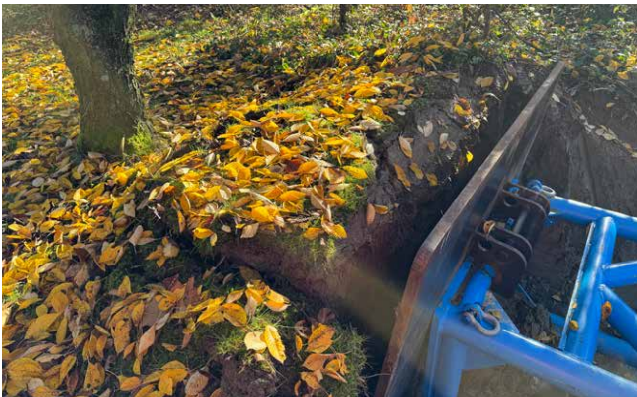
Obrázek 7: Porušený masiv opěry před lafetou (zdroj: fotoarchiv OHLA ŽS, a.s.)
