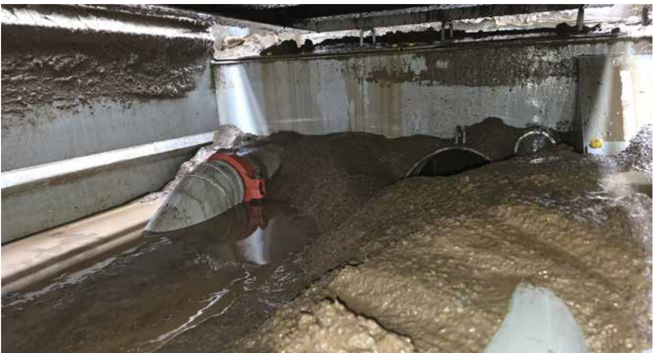
Obr. 8 – Zanesení horní nádrže separačního zařízení HKS150 neseparovatelnými částicemi
