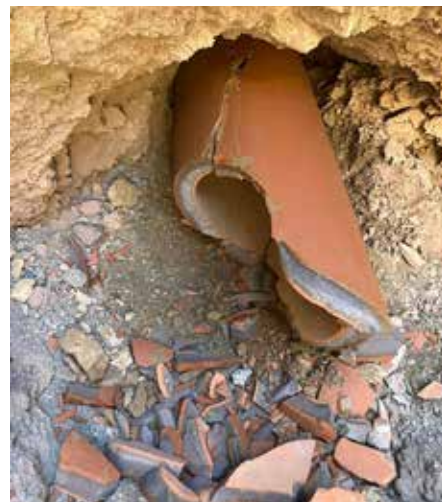
Obr. 10: Kameninové potrubí DN 300 mm bez glazury, poškozené protlácením v poloskalním prostředí
