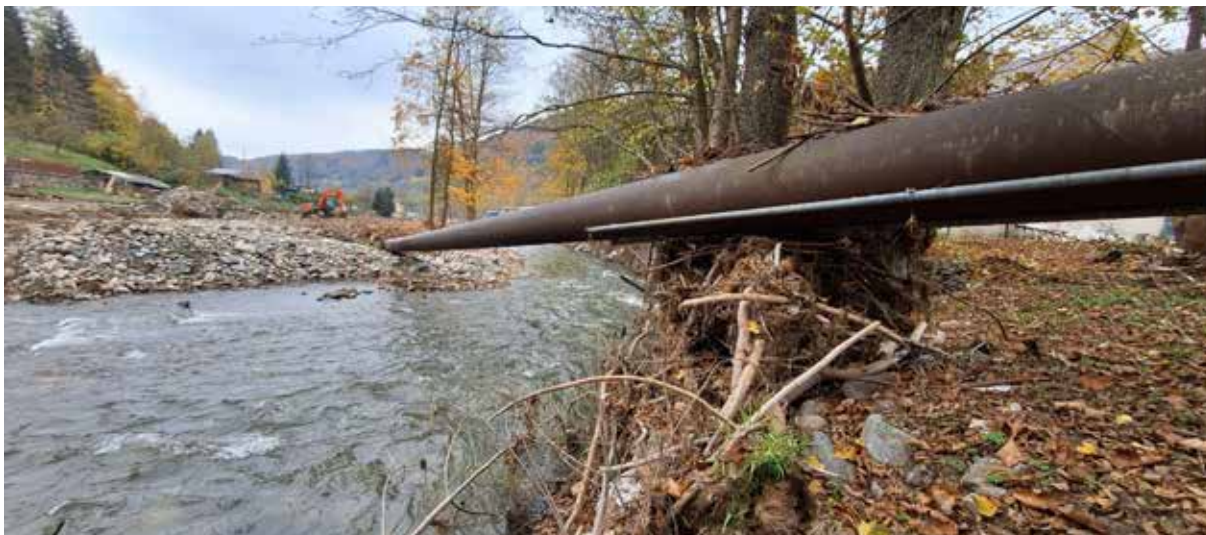
Obr. 2 Řeka Morava – stav po povodni (Zdroj: fotodokumentace zakázky Vodohospodářská zařízení Šumperk, a.s.)
