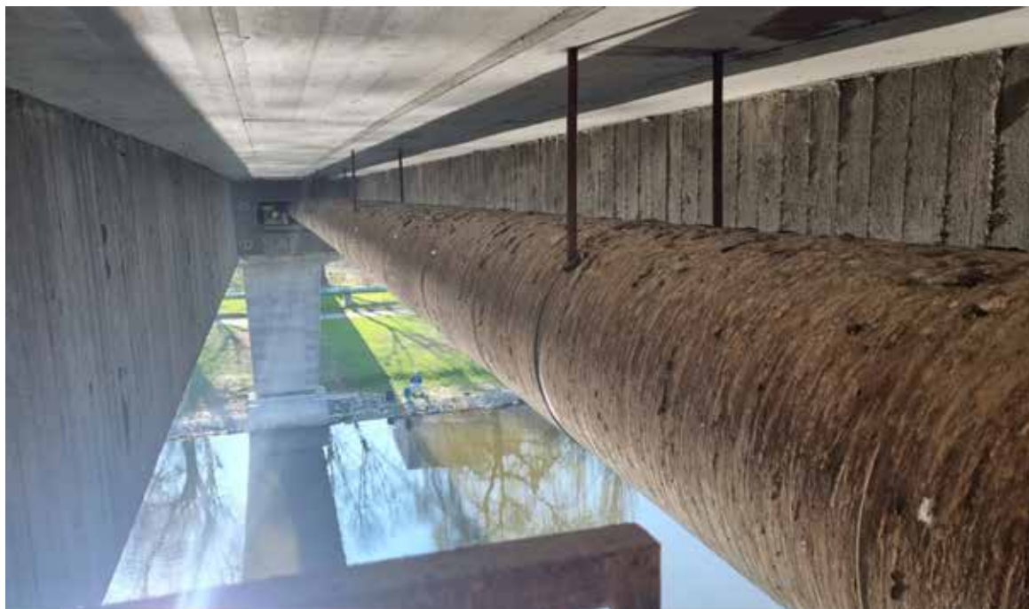
Obr. 2 Ocelové izolované vodovodní potrubí DN 250 v podvěsu mostovky
