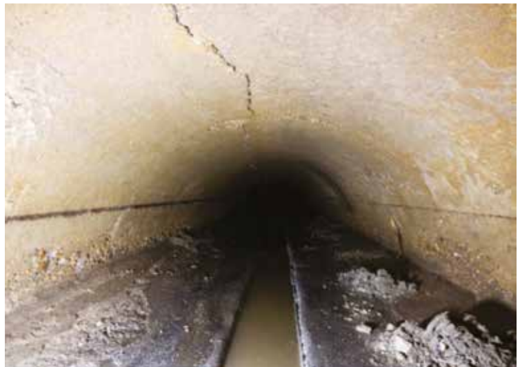
Obr. 2 a 3 Stav kanalizace před opravou
