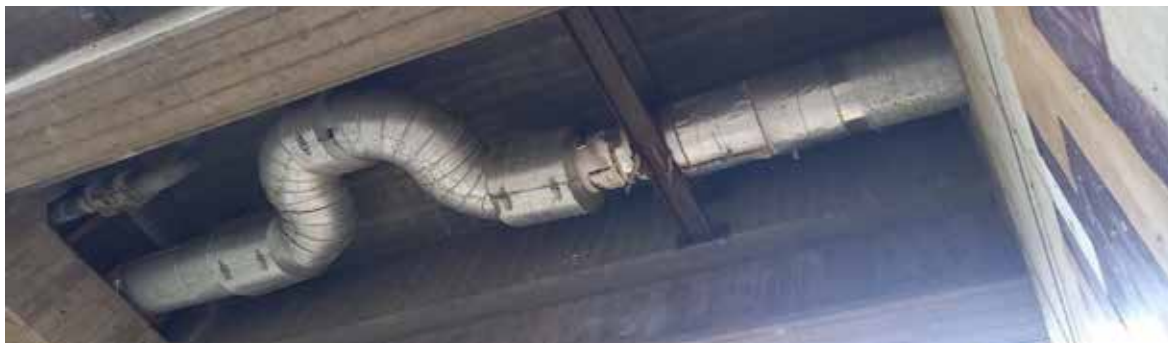
Obr. 3 Kompenzační smyčky před sanací
