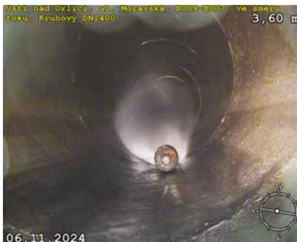
Obr. 4 Stav kanalizace před opravou
