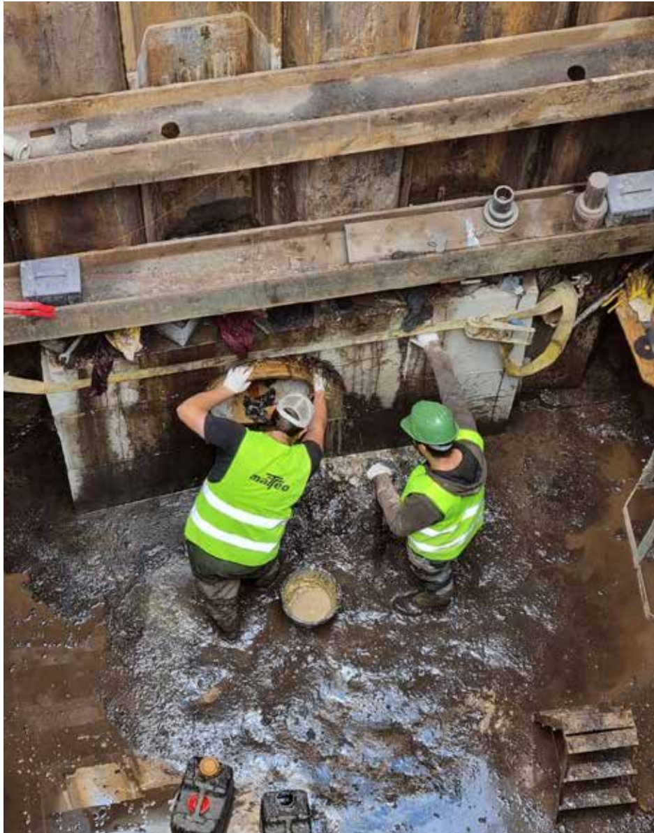
Obrázek 6 – Firma Matteo ČB doinjektovává polyuretanem prostor mezi protlakem a předním prostupovým blokem v Š67
