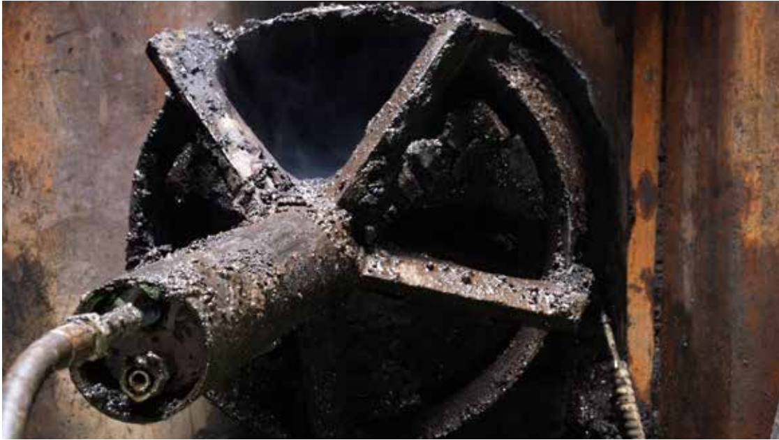
Obrázek 7 – Prorážka rozšiřovací hlavy do cílové šachty – ukázka napojení hadic vysokotlaké vody a bentonitu
